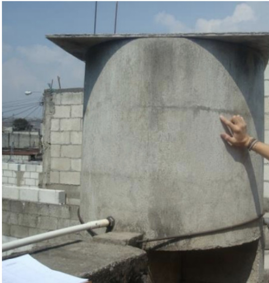
Figura No. 2. Fisuración por contracción del mortero y leve filtración, sin formación de goteo, en funcionamiento normal
