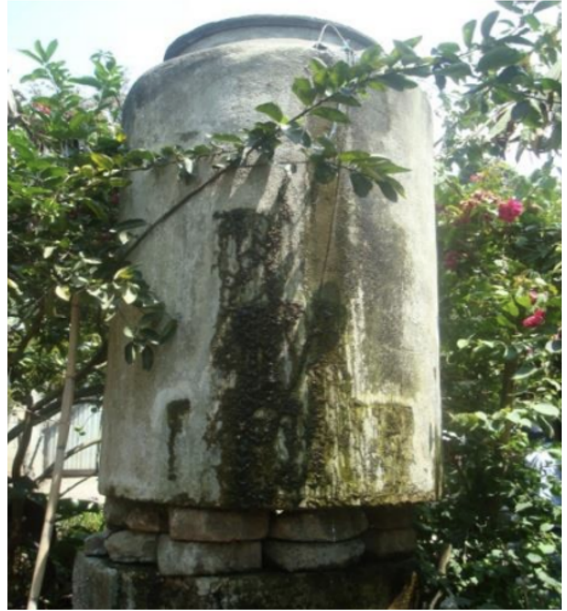
Figura No. 3. Depósito con fisuración de origen mecánico, con filtración, eflorescencias y escamas. Leve goteo, sin embargo, en funcionamiento permanente
