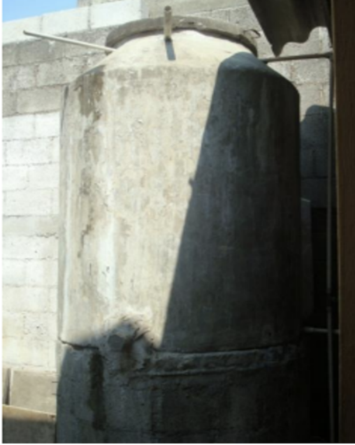
Figura No. 1. Depósito que evidencia fisuración múltiple, pero leve, con poca filtración, en funcionamiento normal durante varios años
