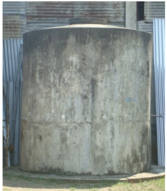
Figura No. 4. Depósito con leve fisuración superficial, sin filtraciones y en perfecto estado de funcionamiento
